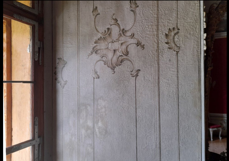
▲ Château d' Eggenberg, salle 5, fenêtre rélèle et lambris avec peinture à l'huile sur toile, détails des dégâts
